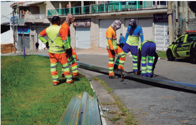
A Prefeitura de Caieiras realizou a instalação de defensas metálicas na Rua Arnaldo Cunha Leite, no
